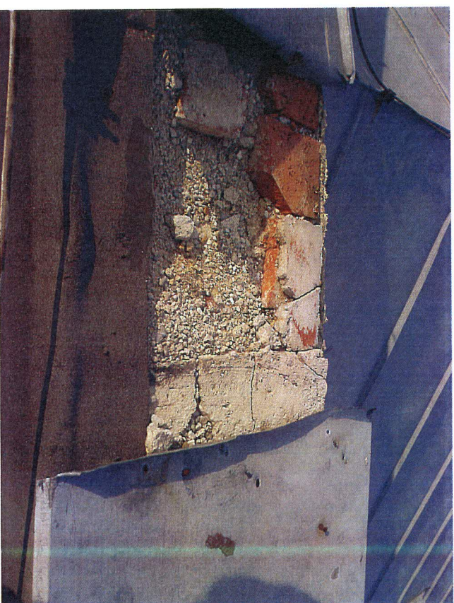
Úplne zvetraný, nesúdržný podklad, do ktorého je zatlčený upevňovací klinec
