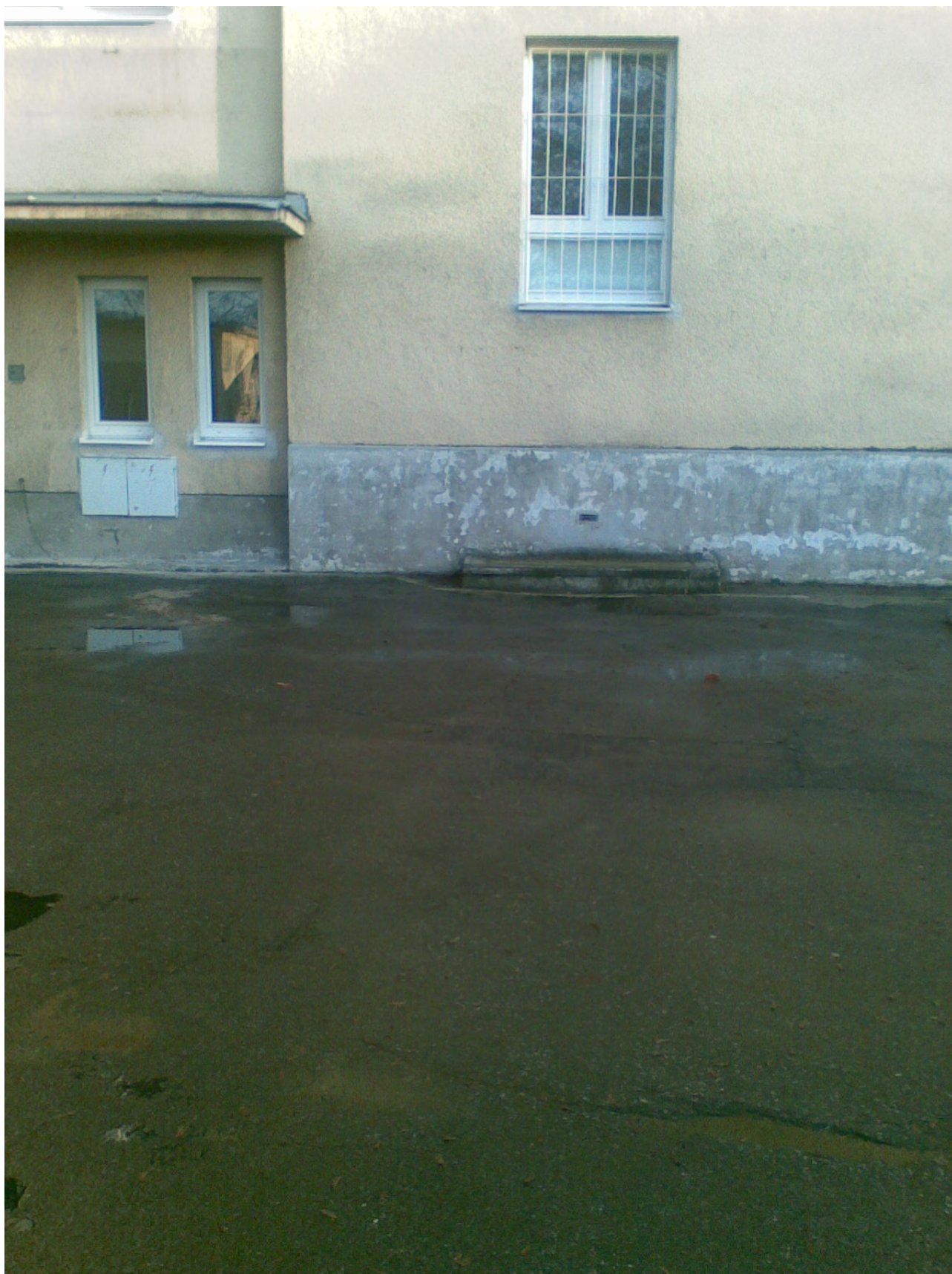
Miesto poruchy pred budovou č. 30, Jaselské kasárne Topol'čany.
