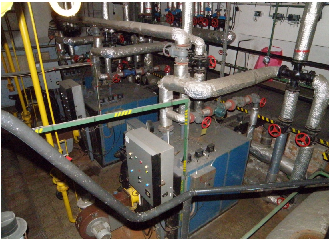
Pohľad na kotly
