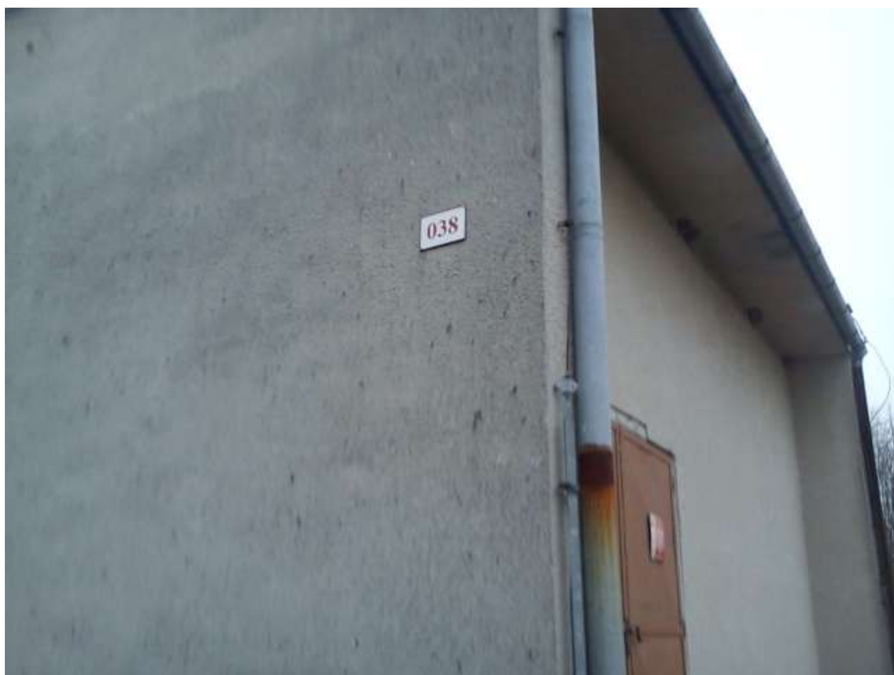
Trafostanica b. č. 038
