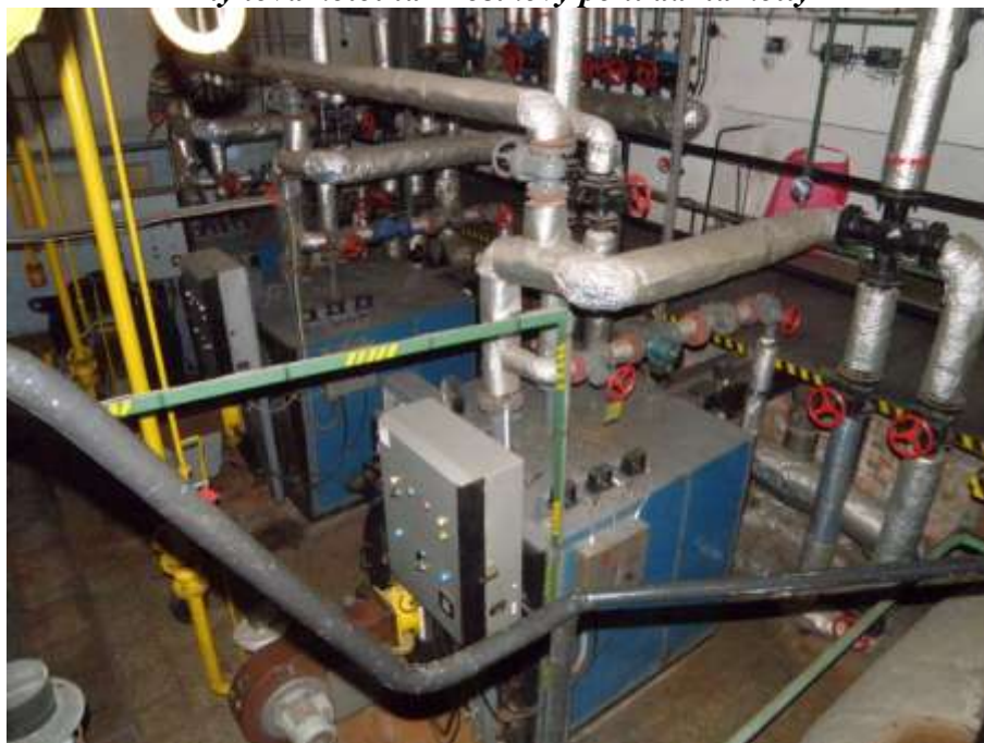
Plynová kotolňa – celkový pohľad na kotly
