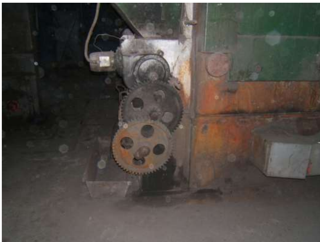
Prevodové súkolie kotla
