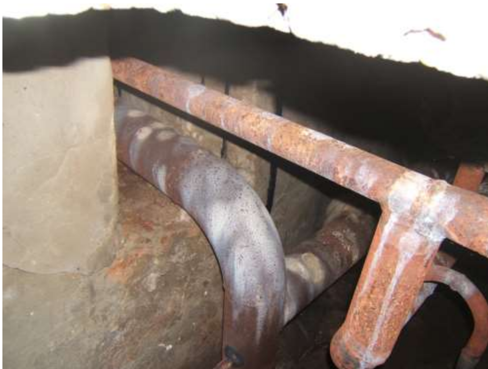
Potrubie pary DN 150mm v šachte b.č. 11
