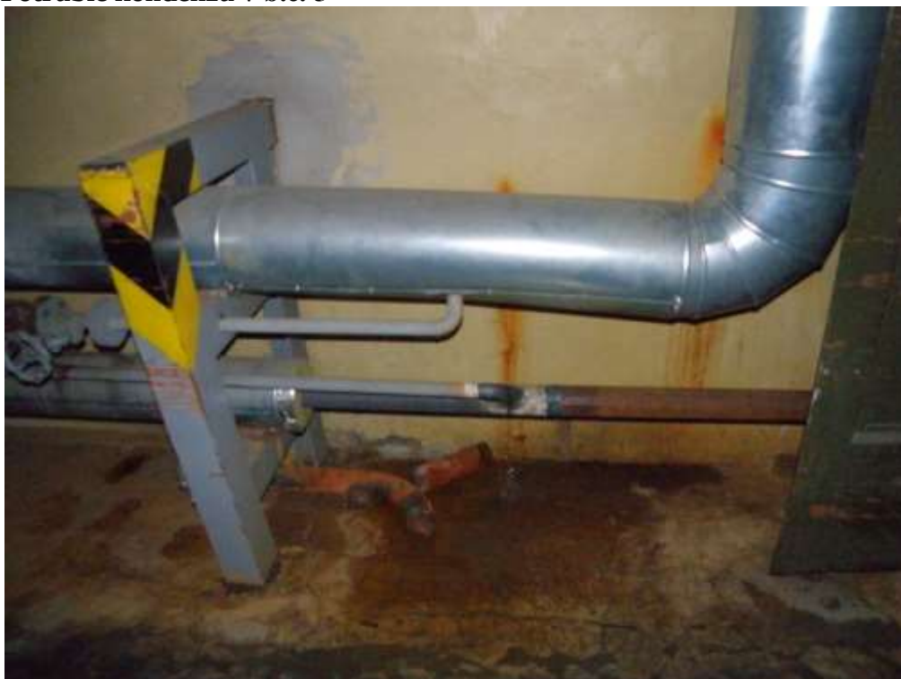
Potrubie kondenzu v b.č. 5
