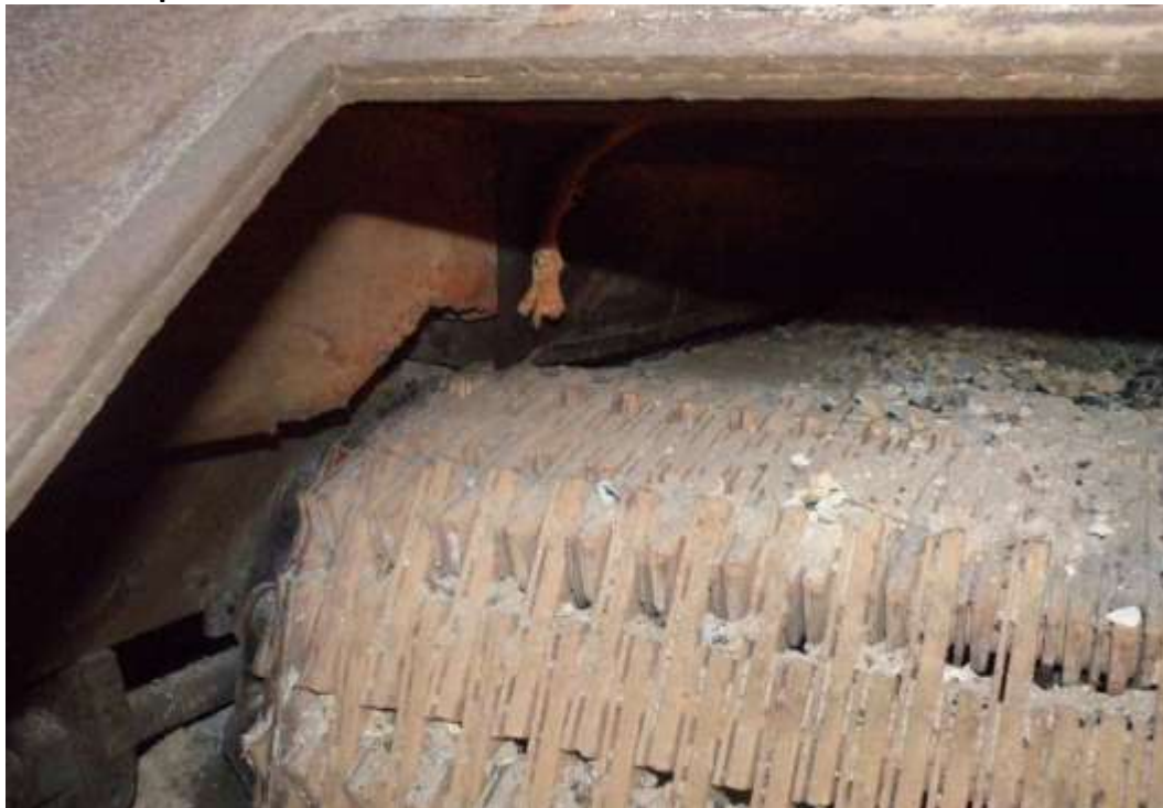
Kotel K1 – pohľad na rošt
