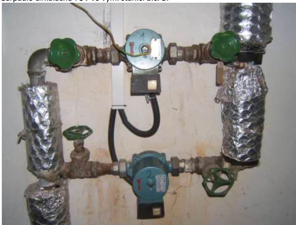
Čerpadlo cirkulačné TÚV vo vým. stanici b.č. 17
