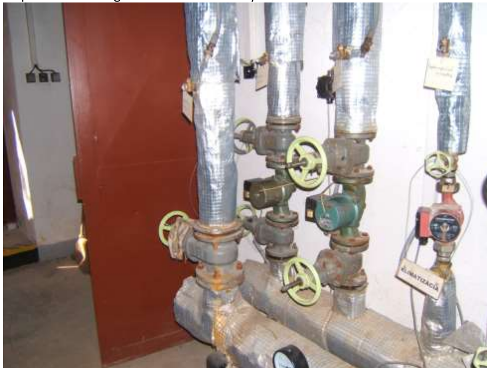
Čerpadlo 50 NTV Sigma - obehové ÚK vo vým. stanici b.č. 22
