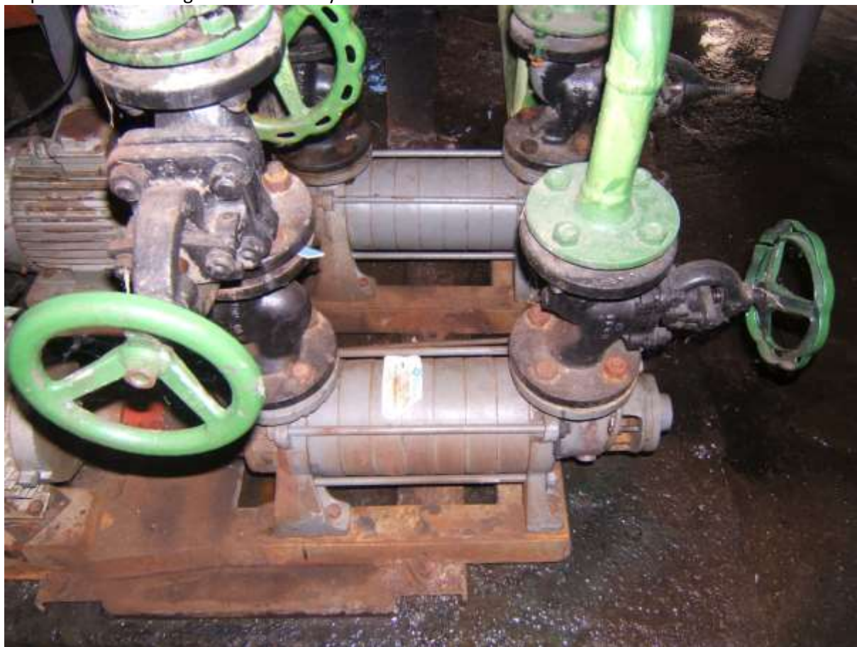
Čerpadlá kondenzu Sigma 32 HVN vo vým. stanici b.č. 62
