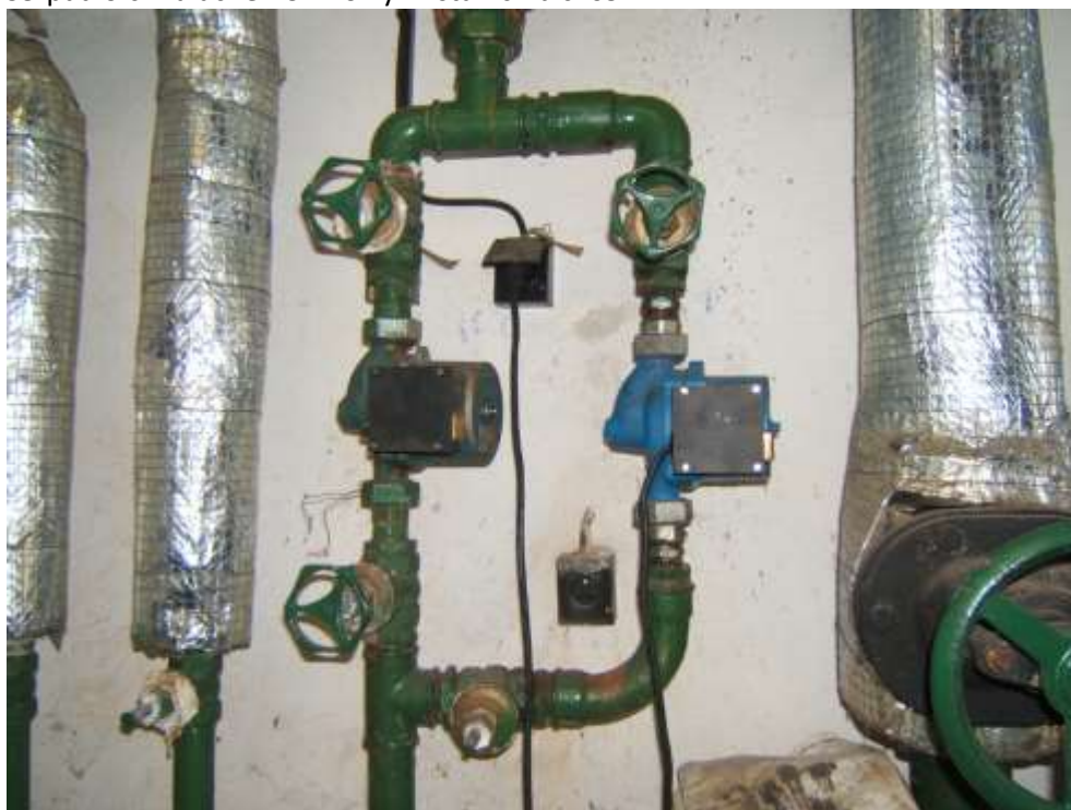
Čerpadlo cirkulačné TÚV vo vým. stanici b.č. 69
