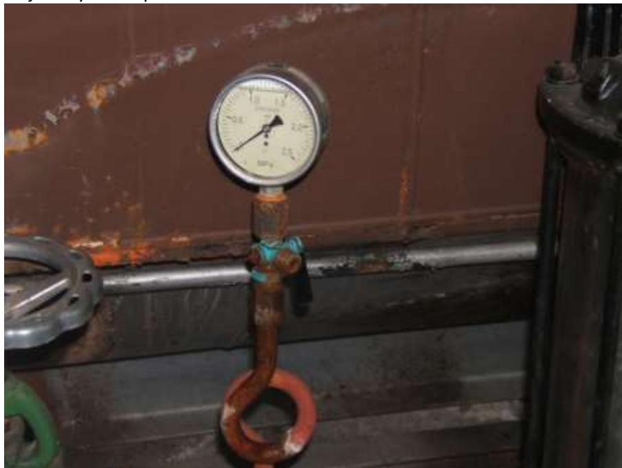
Trojcestný kohút pod manometrom – K2
