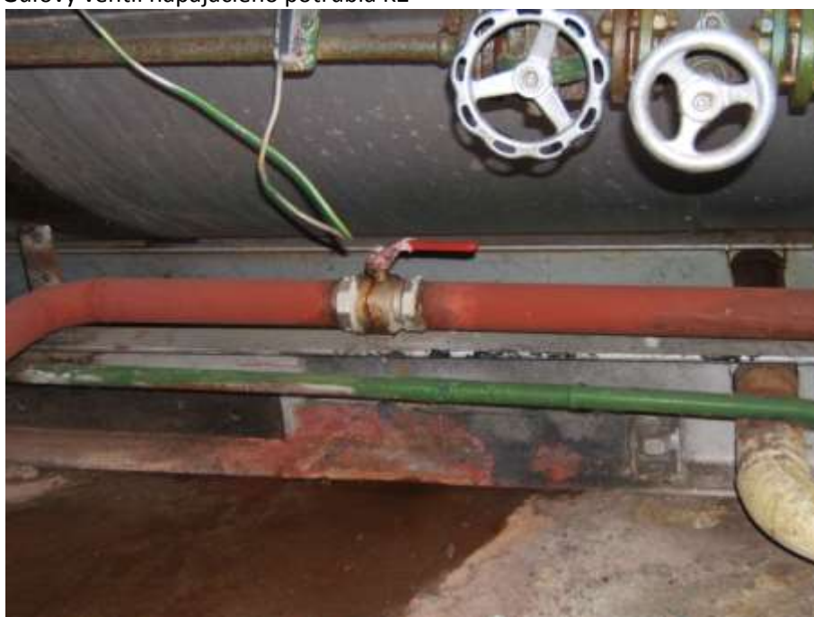
Guľový ventil napájacieho potrubia K2
