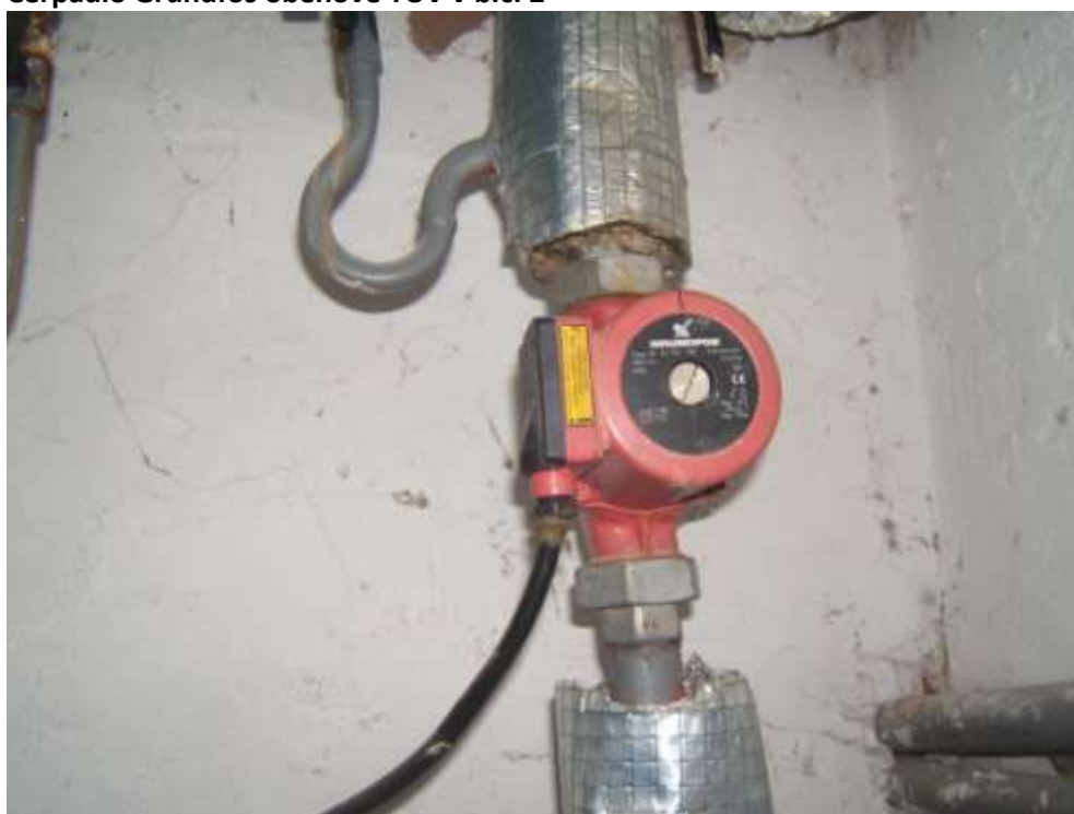
Čerpadlo Grundfos obehové TÚV v b.č. 2
