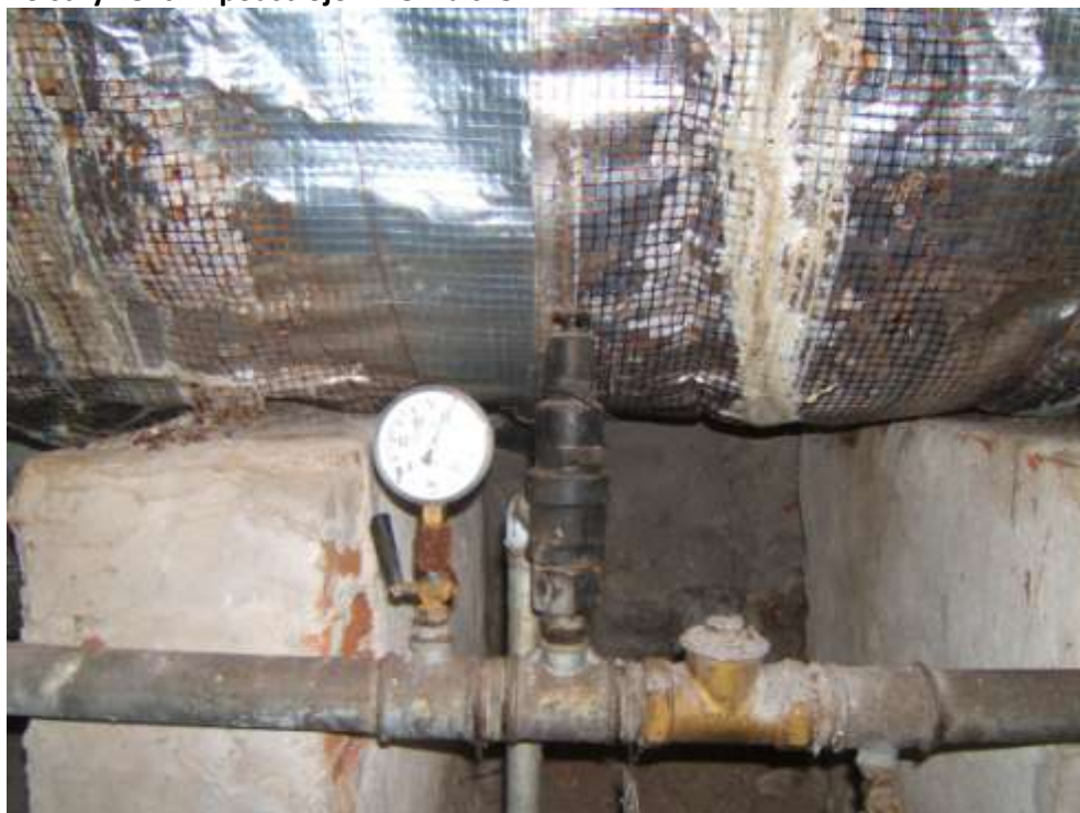
Poistný ventil v podstrojovni ÚK b.č. 8A
