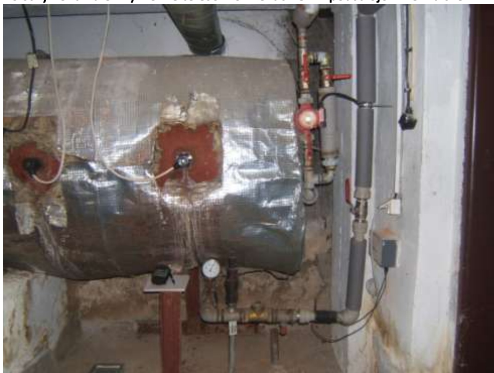
Poistný ventil a el. výhrevné teleso – ohrievač TÚV v podstrojovni ÚK b.č. 8B
