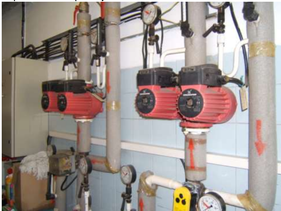
Čerpadlá Grundfos v podstrojovni ÚK b.č. 60
