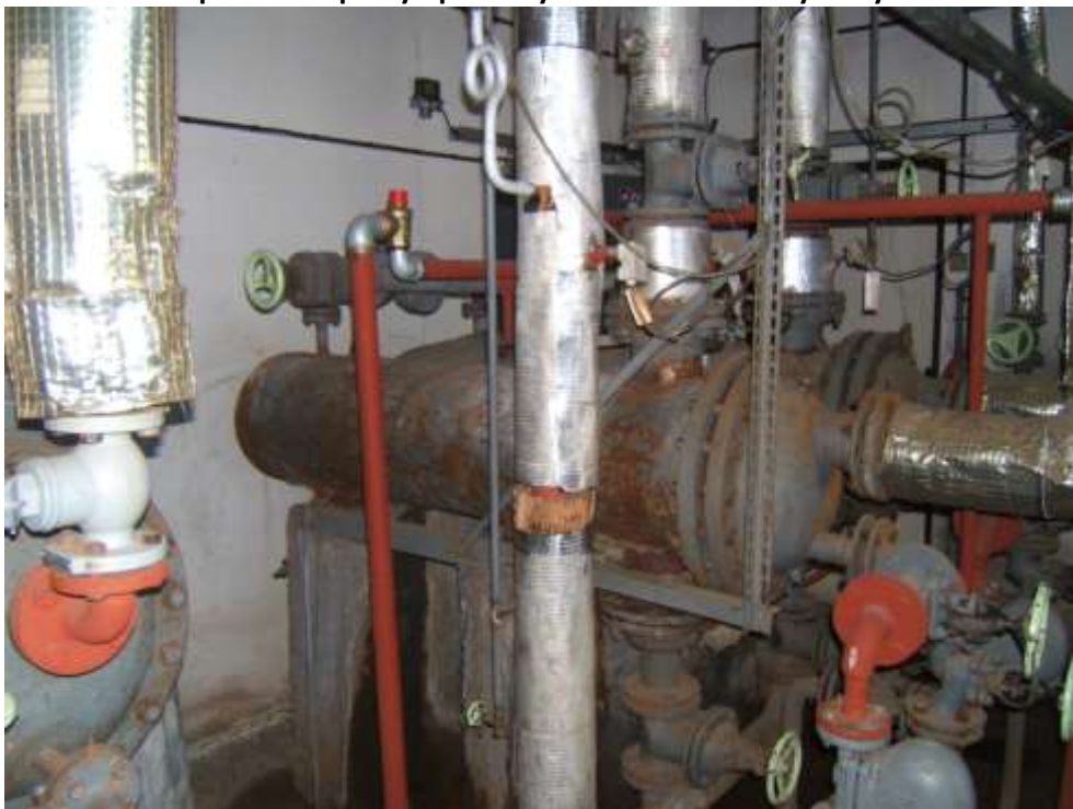
Výmenník tepla vo výmenníkovej stanici b.č. 76, Sliač kasárne predmet opravy oprava výmenníka formou výmeny
