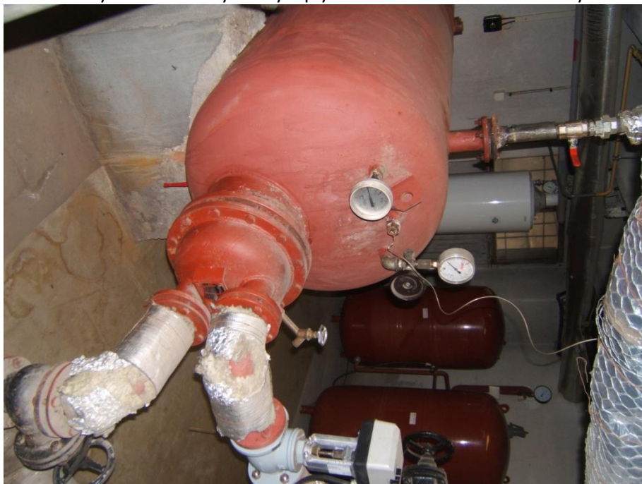
Zásobníkový ohrievač vody ležatý – plyn. kotolňa vo Vel.budove B. Bystrica
